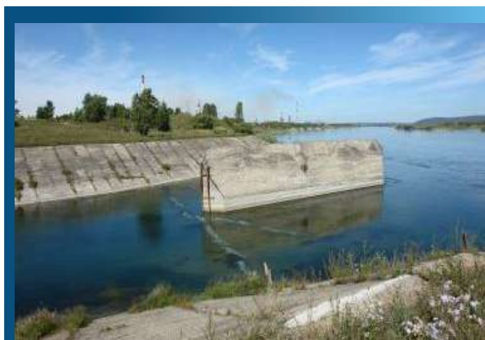
Водозабор АО «АЭХК»
